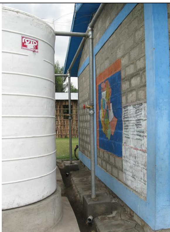
Svislá část potrubí odvádí první špinavější vodu ze střechy po dešti do odvodňovacích žlabů podél školy, aby nešla do tanků. Potrubí je uzavíratelné ventilem.
