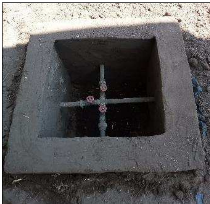
Foto 8: Konstrukce ventilové komory o rozměru 120x120cm včetně betonového krytu v Umbulo Tanakaka ZC, 2021
