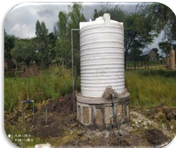
2 – Škola Argeda Haro Dimtu - nádrž
