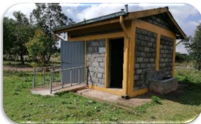
4 - Latríny s umývárnou Argeda Haro Dimtu
